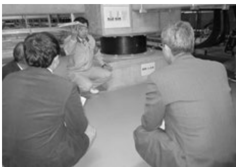
▲免震重要棟の免震装置
