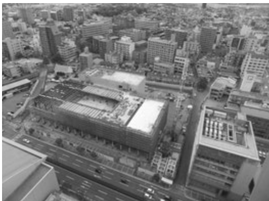
◀大分県の未来への一里塚となる県立美術館の工事現場
