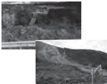
▲2.7～8 熊本地震で被災した国道57号と豊肥本線、南阿蘇村の現場は復旧作業中です。大分県と熊本県をつなぐ大動脈の早期復旧をJR九州にも要請しました。
