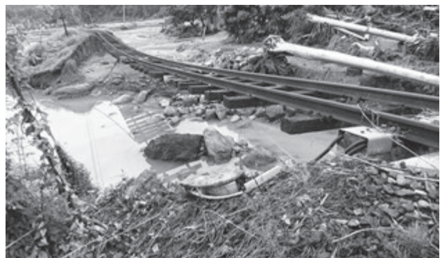
▲日田彦山線では、各地で盛土が流失（宝珠山・大鶴付近）
