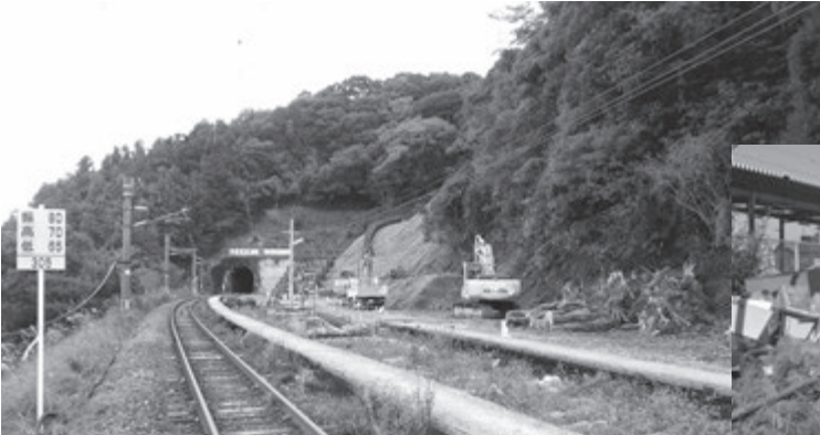
◀台風18号で被災したJR日豊本線津久見市徳浦信号所の現況
