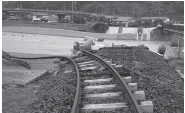
▲流失した久大本線花月川橋梁
