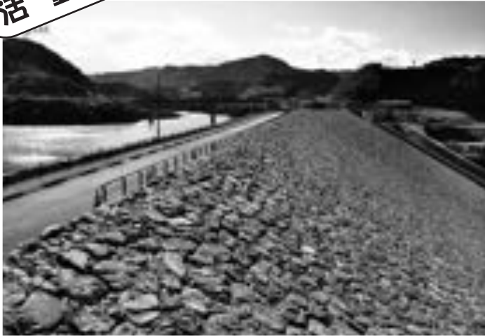
▲ななせダム（中央コア型ロックフィルダム）
